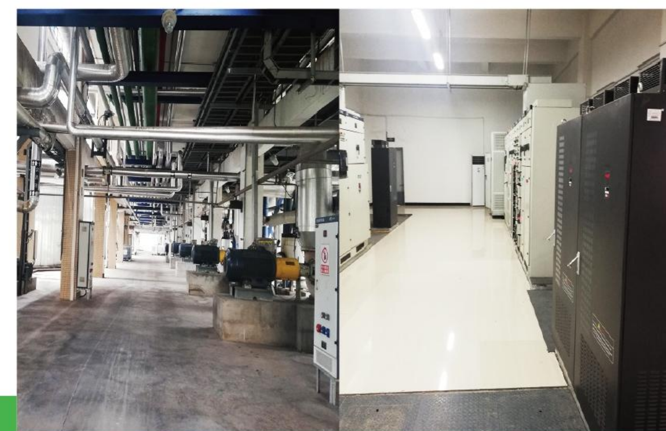
变频器在纸厂水泵上的应用
