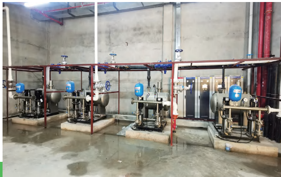
变频器在楼宇供水上的应用
