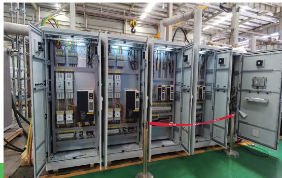
变频器在直流输电换电站上的应用
